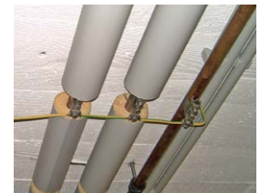
Heizungsrohre verbunden mit dem Potentialausgleich
